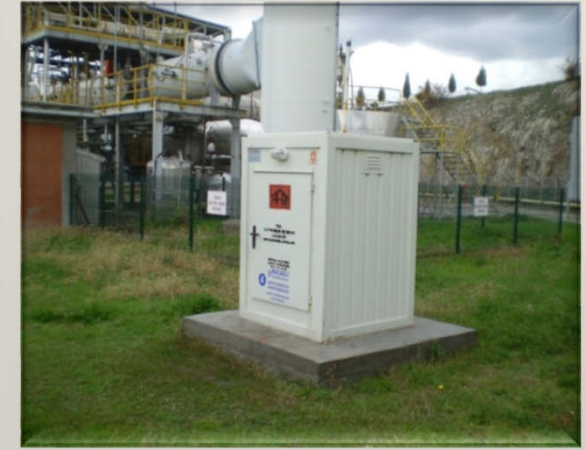
İZAYDAŞ (Katı atık yakma tesisi)
