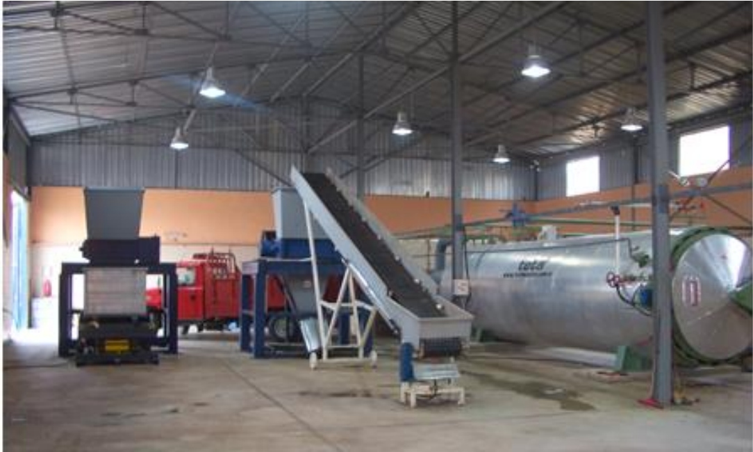
Şekil-3a Tıbbi Atık Sterilizasyon Tesisi İç Görünüş
