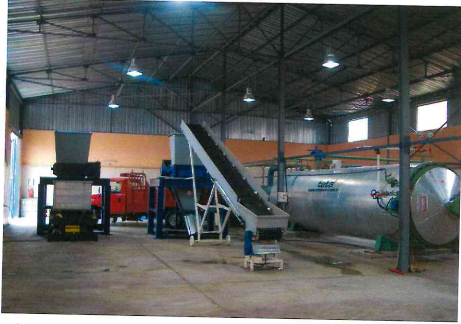
Şekil-3 Tıbbi Atık Sterilizasyon Tesisi
