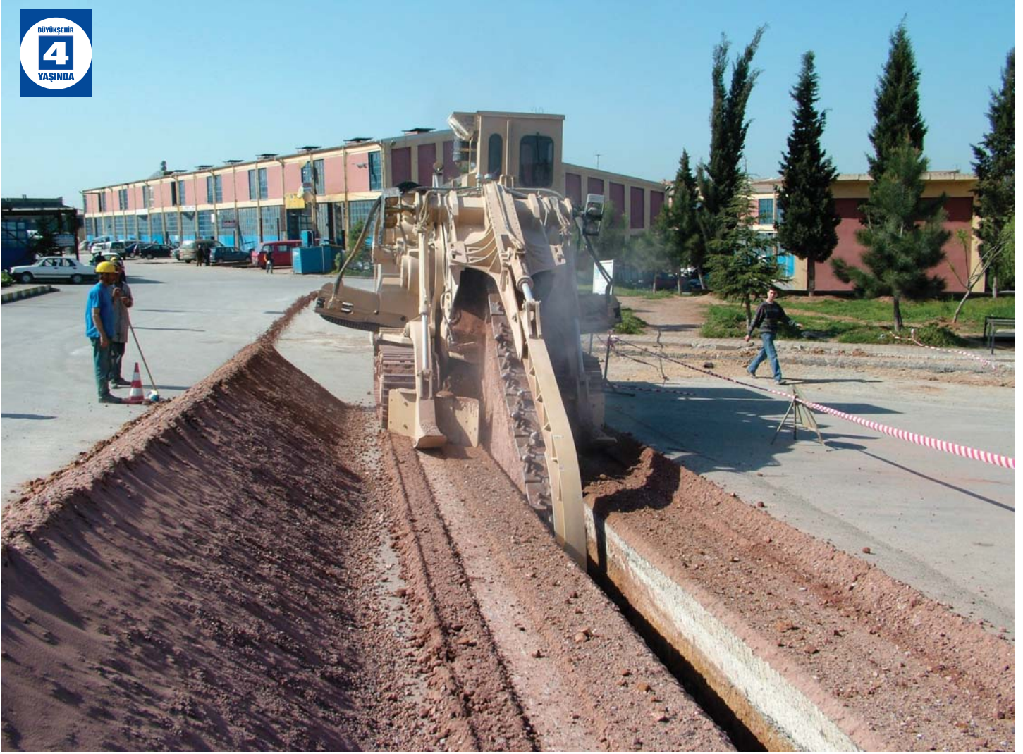
İçme Suyu Hattı
