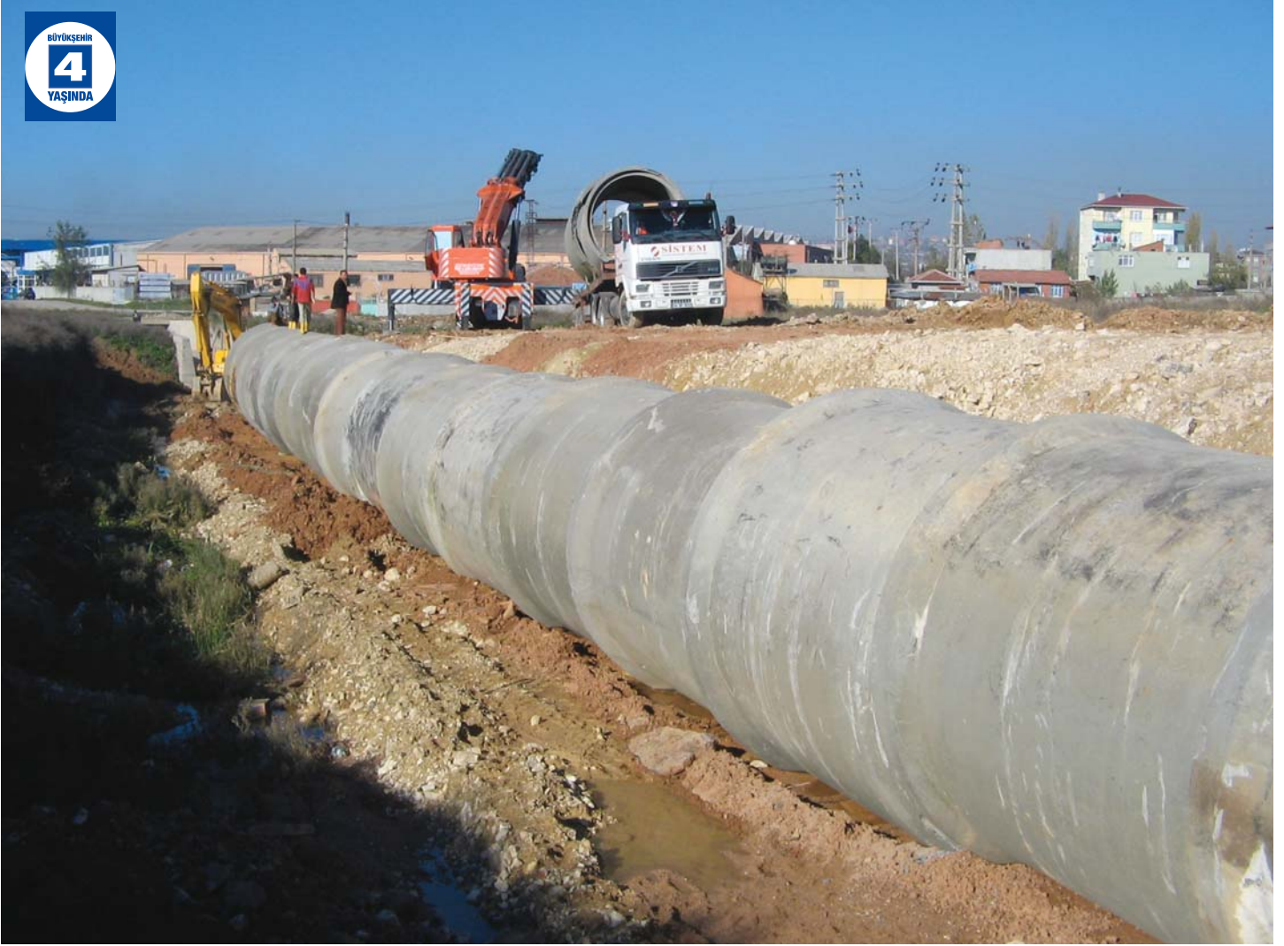
Yağmur Suyu Kolektör Hattı
