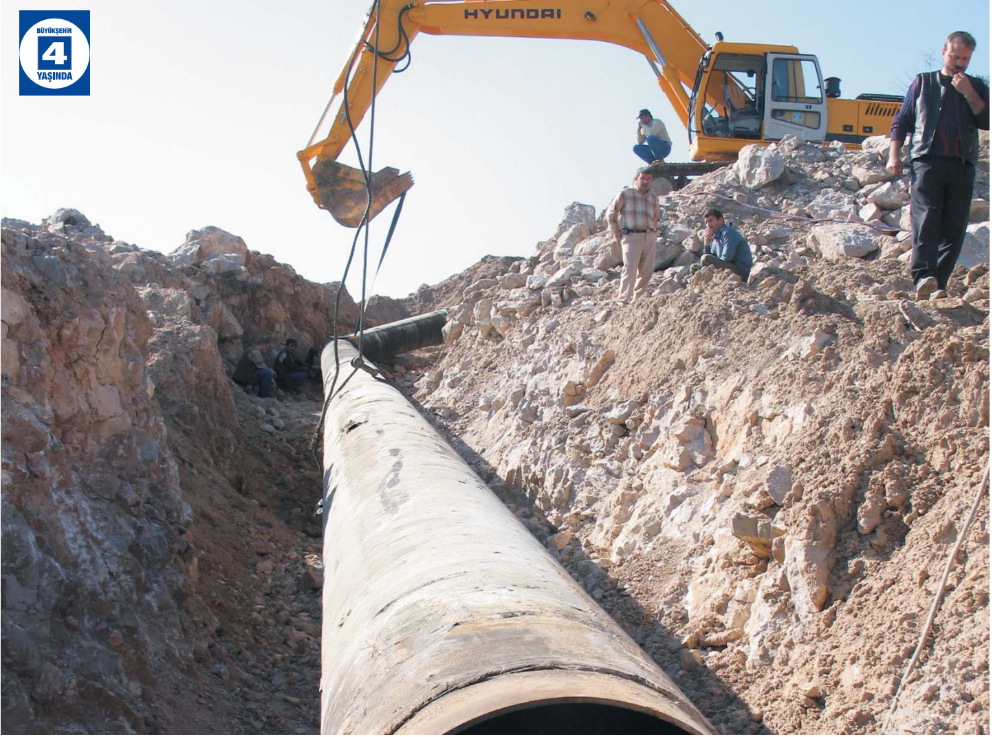
İçme Suyu Hattı
